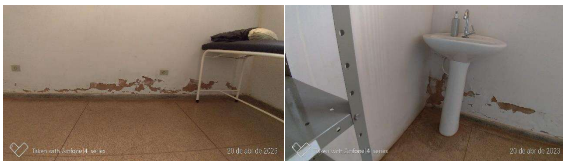
Sinais de descascamento das paredes internas, indicando a necessidade de manutenção e pintura geral.
