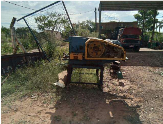
Picador/Triturador de Madeira (Poda de Árvore) inoperante. Equipamento adicional, cuja rede elétrica não possui capacidade para suportar o seu funcionamento.
