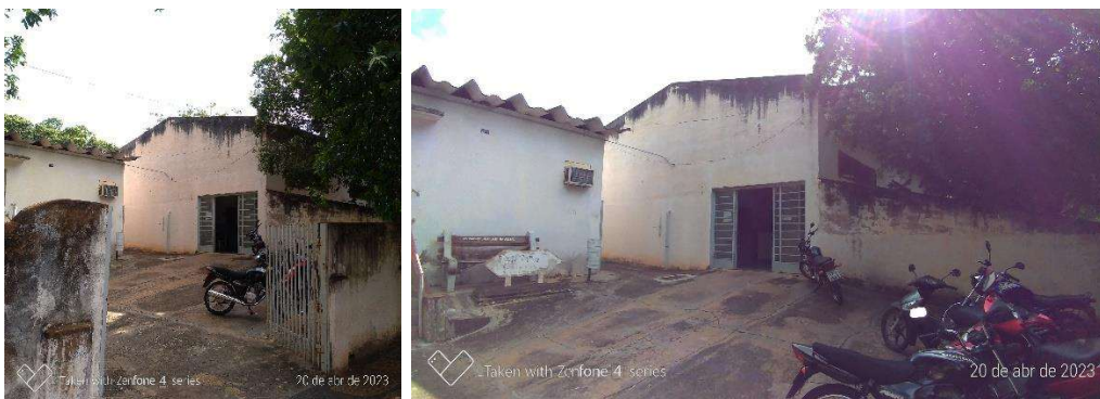
Fachada do imóvel onde são desenvolvidos os serviços, indicando a necessidade manutenção e reforma.
