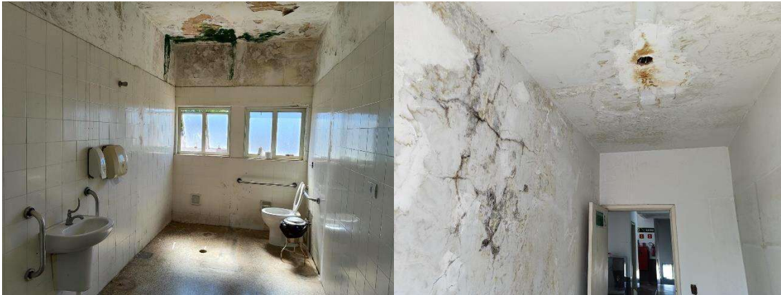
(Fotos cedidas pela Coordenação do CEO) - Severas infiltrações decorrentes de inundação ocorrida na cobertura do imóvel, um dos motivos da reforma em andamento e da suspensão total dos atendimentos.
