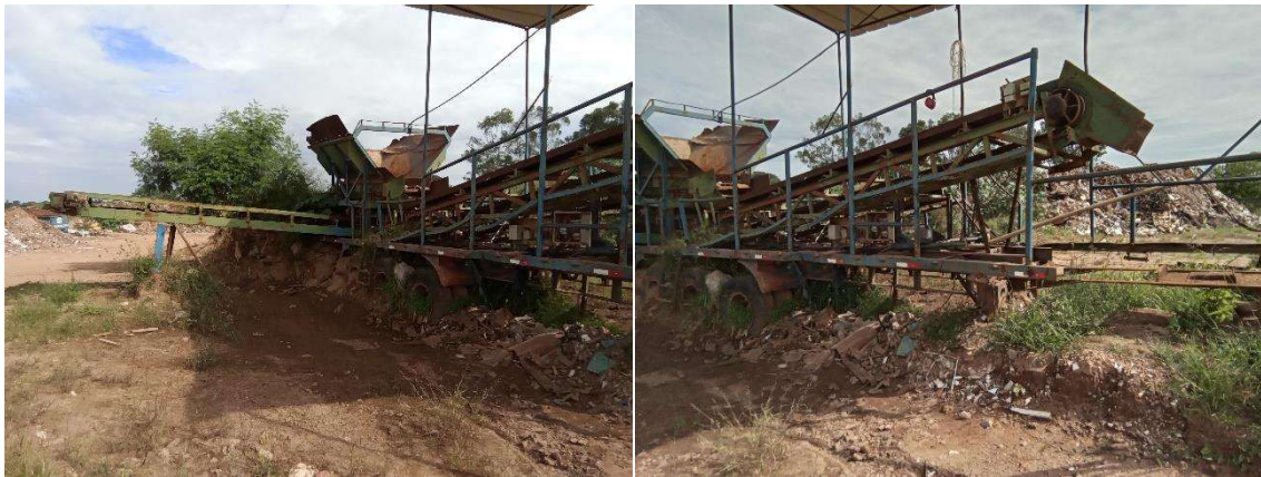
Equipamento de processamento de Resíduos de Construção Civil (RCC) e esteira de triagem inoperantes.
