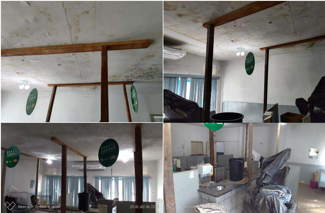
Módulo odontológico em condições precárias, com o teto sustentado por estacas de madeira, indicando possibilidade de desabamento.
