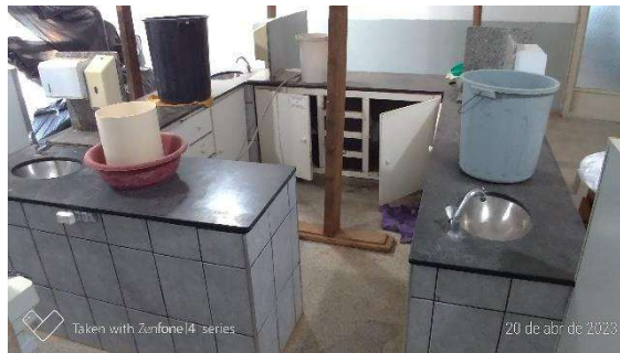
Baldes sobre os balcões do módulo odontológico destinados a recolher água das goteiras do teto.
